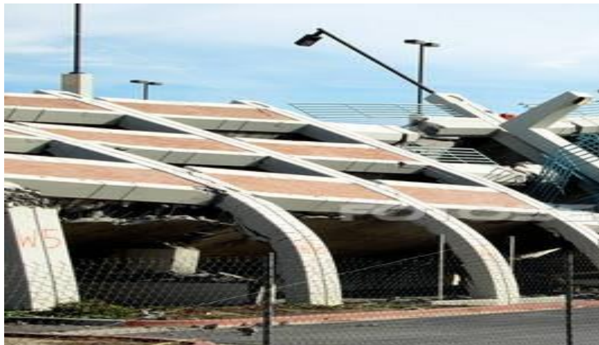
Loše odabran konstruktivni sistem, zemljotres Northridge, Los Angeles, 1994, skeletna konstrukcija, opeka ispunjena
